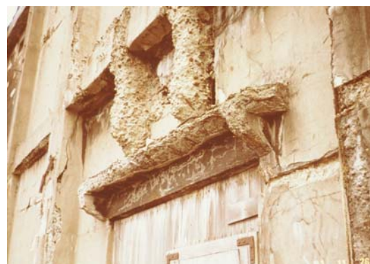
写真-2 凍害による劣化
