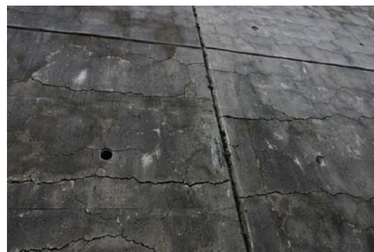
写真-3 アルカリ骨材反応による劣化
