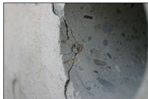
写真-1 中性化による鉄筋の腐食・膨張とコンクリートのひび割れ
